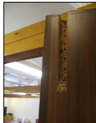
Voids in a fire door
